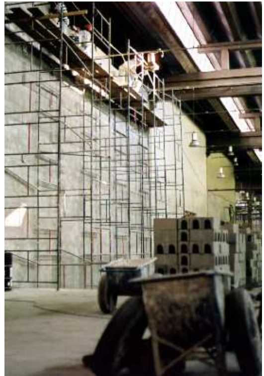
Elevação da estrutura contra fogo.
