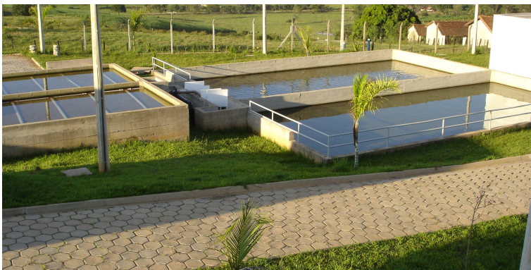
Vista do reservatórios da ETA
